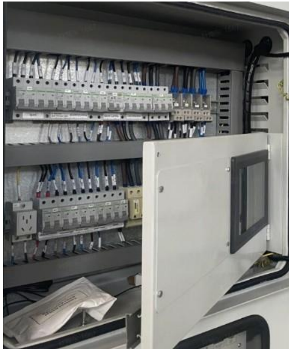
Figura 6- 2 Instalación de la pantalla y el control del BMS
