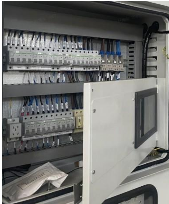
Figura 6- 2 Instalação do visor e controle do BMS
