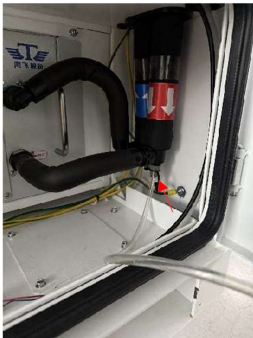
Figura Anexo 6- 11 Salida de drenaje en la parte inferior de la tubería de refrigeración líquida
