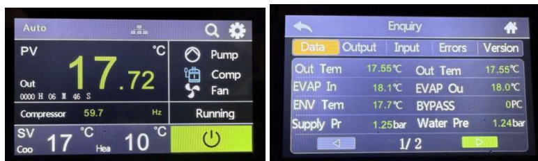
Figura Anexo 6- 27 Observe la presión de inyección de líquido
