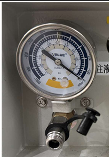
Figura Anexo 6- 23 Presión de la bomba de vacío
