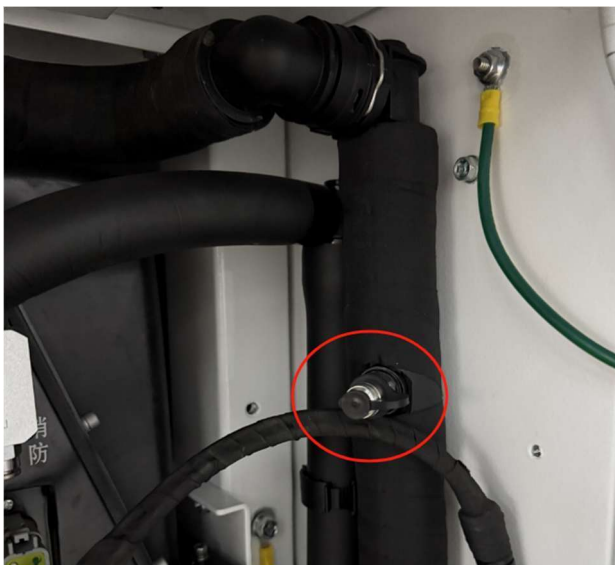
Figura Anexo 6-18 Posición de la válvula de escape en la tubería de refrigeración líquida
