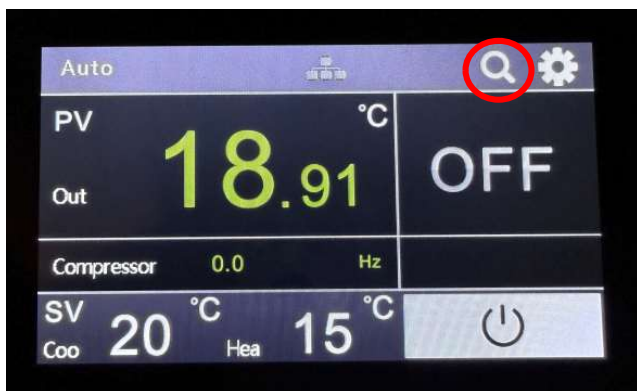
Figura Anexo 6-20 Ecrã da unidade de refrigeração líquida
