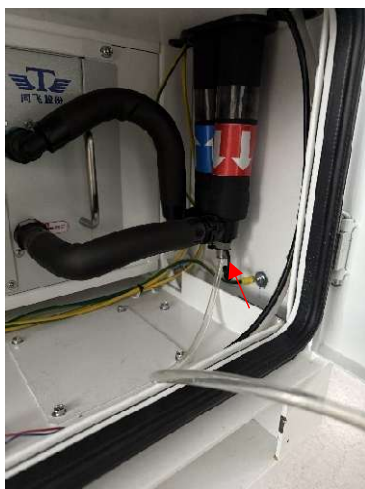
Figura Anexo 6-11 Saída de drenagem na parte inferior da tubagem de refrigeração líquida
