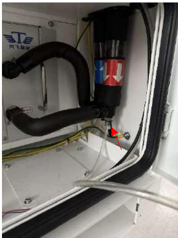
Figura Anexo 6-10 Salida de drenaje en la parte inferior de la tubería de refrigeración líquida
