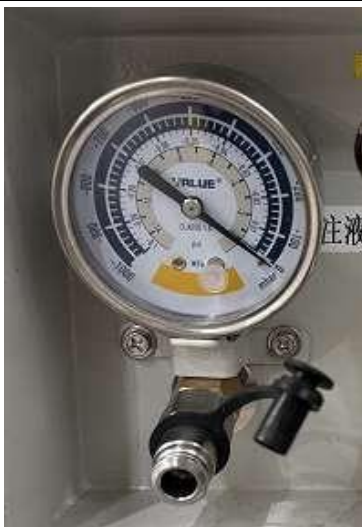
Figura Anexo 6- 22 Presión de la bomba de vacío
