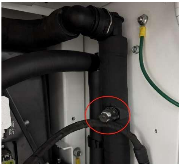
Figura Anexo 6-17 Posición de la válvula de escape en la tubería de refrigeración líquida
