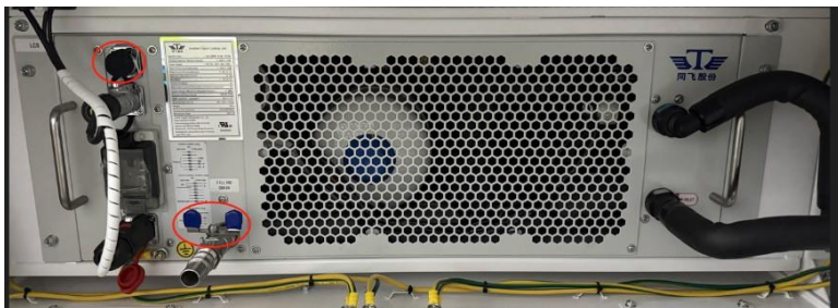
Figura Anexo 6-16 Fiação do visor da unidade de resfriamento líquido e posição da válvula de drenagem
