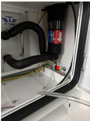
Figura Anexo 6-10 Saída de drenagem na parte inferior da tubulação de resfriamento líquido
