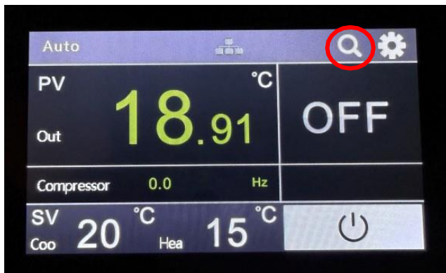
Figura Anexo 6-19 Visor da unidade de refrigeração líquida
