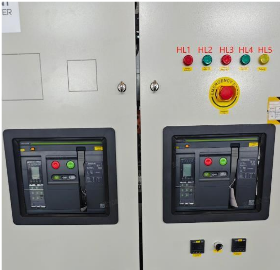
Figura 4-5 Indicadores del armario de baja tensión
