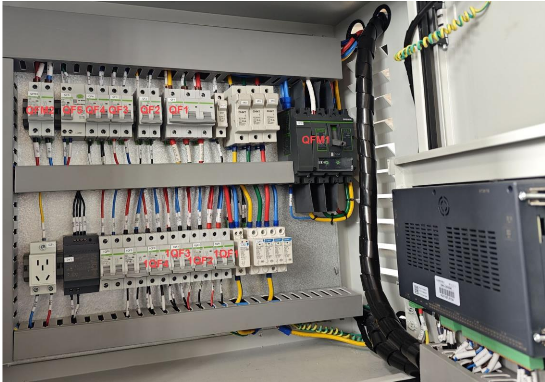
Figura 4- 3 Disyuntor del contenedor de baterías
