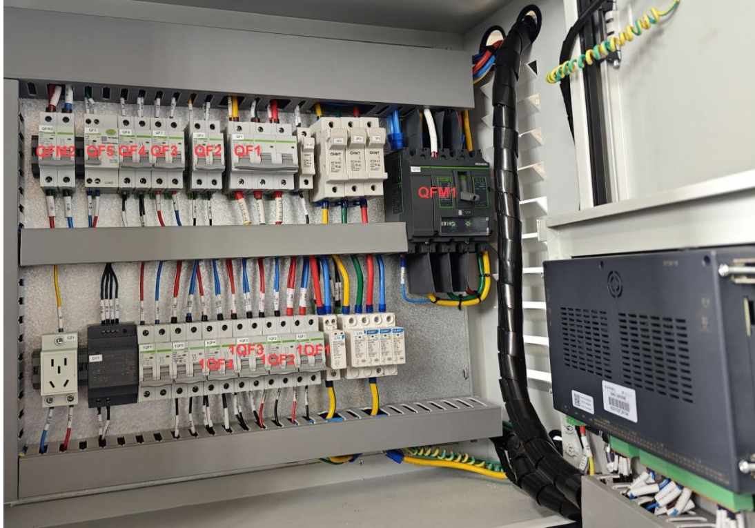
Figura 5-3 Disyuntor del contenedor de baterías
