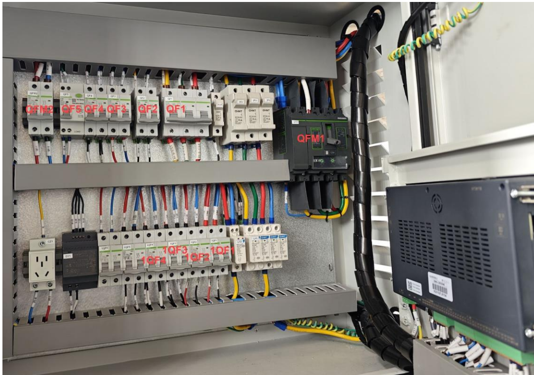
Figura 5-3 Disjuntor do contêiner da bateria
